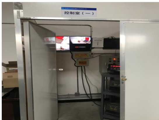
摄像监控系统
